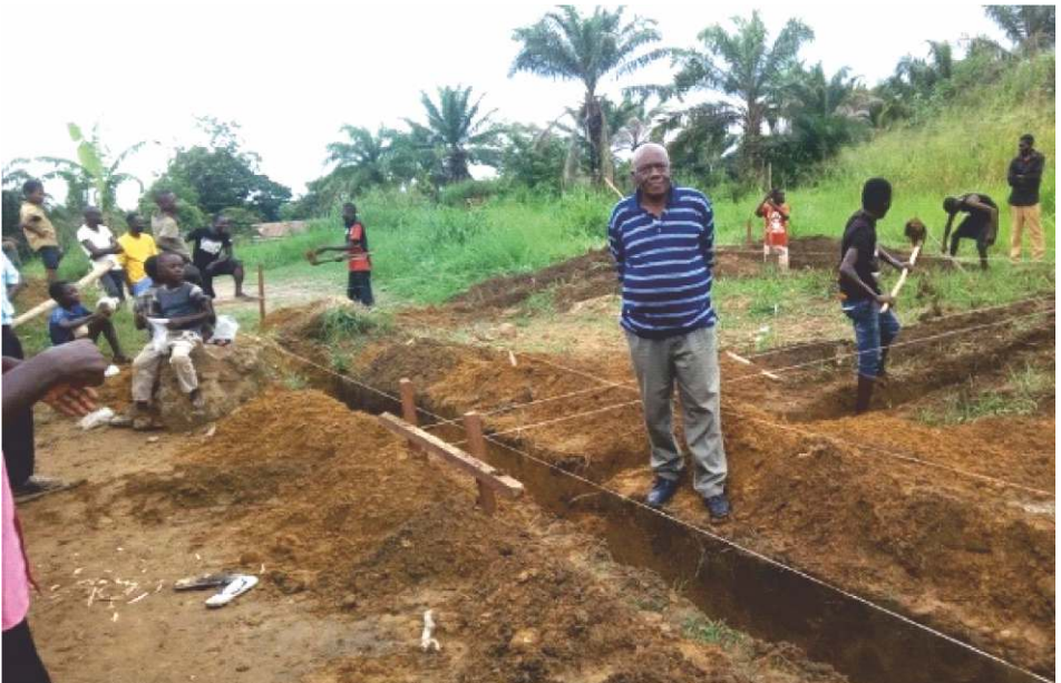
Schulleiter Papa Bolaa Ibanga (Mitte) verfolgt die Gründungsarbeiten für das neue Schulgebäude
